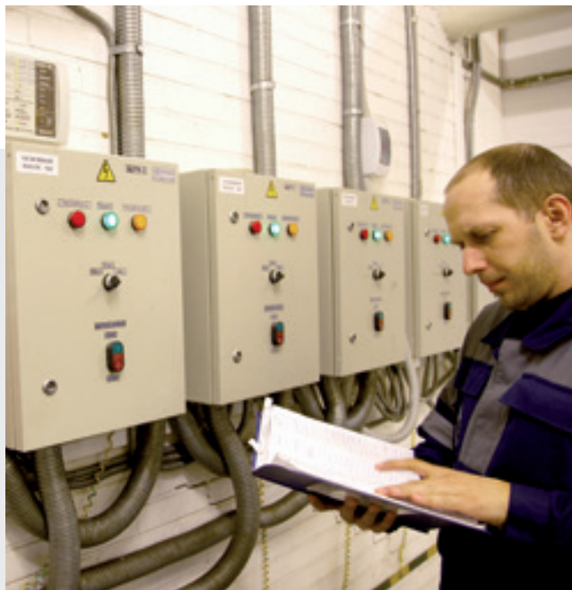
Автоматика управления системой пожаротушения
